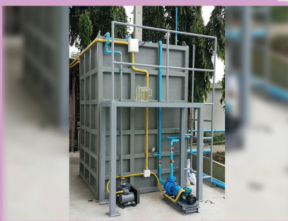
ระบบ MBR ที่บำบัดน้ำชะขยะจากสถานีขนถ่าย ขยะเทศบาลเมืองสระบุรี จ.สระบุรี
